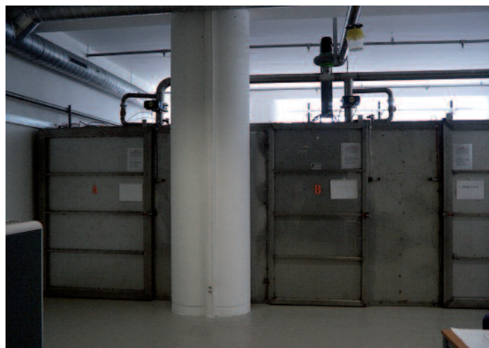
Les trois enceintes de traitement (volume de l'ensemble : 95 m 3 répartis en 2 x 35 m 3 + 25m 3 ) © M. Gunn
